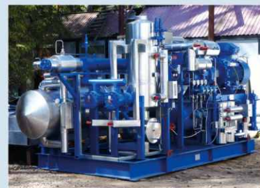
Фото 7. Пропановая чиллерная установка для охлаждения этиленгликоля.
