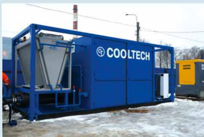
Фото 6. Контейнерная автономная аммиачная установка.
